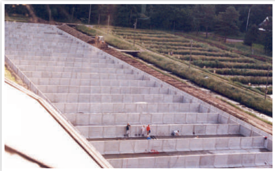
De "små" mennesker her i det store anlæg i Rindsholm, som udelukkende er opbygget af L-150-elementer, giver et godt indtryk af hvor stort dette dambrugsbyggeri i virkeligheden er
