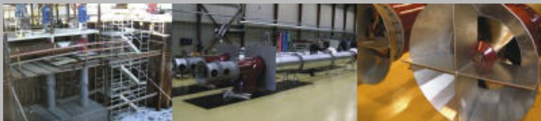
Dokpumper til skibsværft, tørdok installation.
