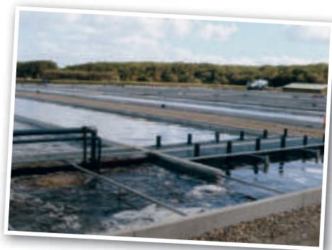
Det færdige dambrug – nu med både vand og fisk, opført med Give elementer.
