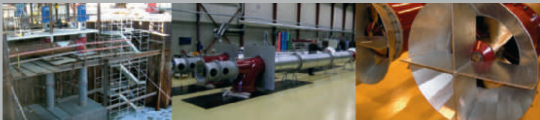
Dokpumper til skibsværft, tørdok installation.
